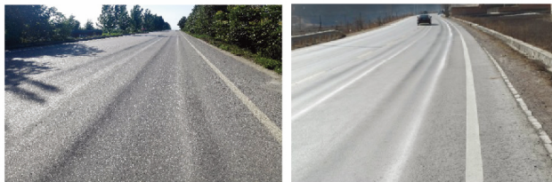
图4 某国道坡道路段夏季高温时产生的失稳型车辙
